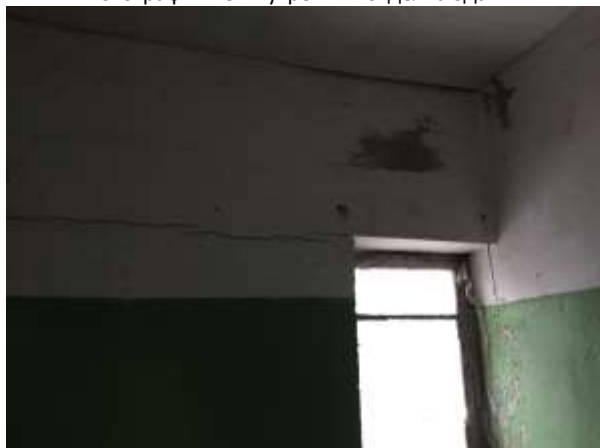
Фотография 15 Трещины в стене
