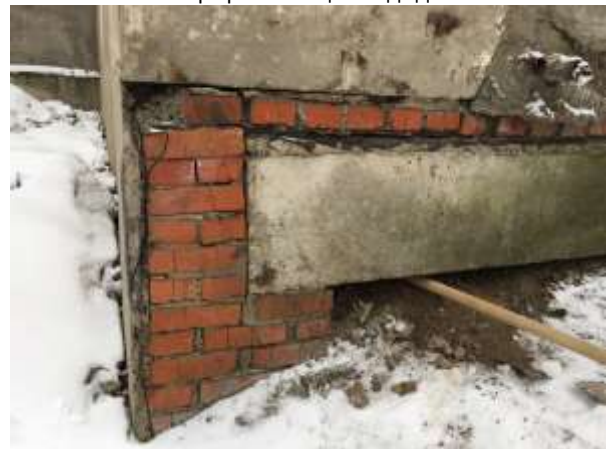
Фотография 10 Повреждение несущих конструкций здания
