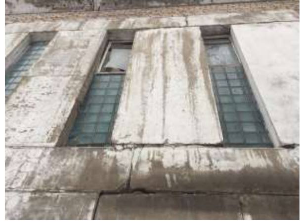
Фотография 6 Трещины на фасаде здания, повреждение остекления
