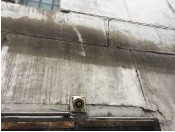
Фотография 5 Трещины на фасаде здания
