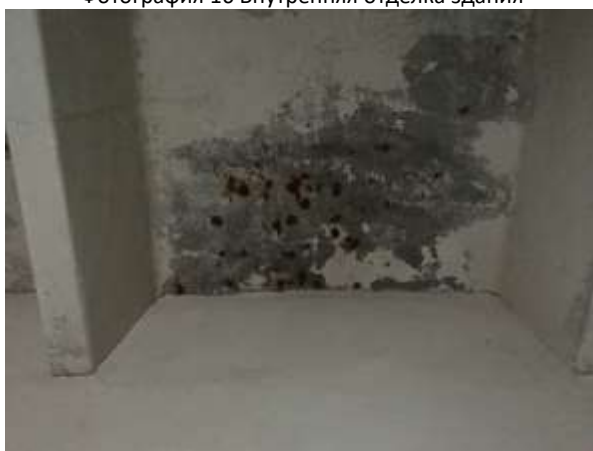
Фотография 18 Следы протечек на перекрытиях
